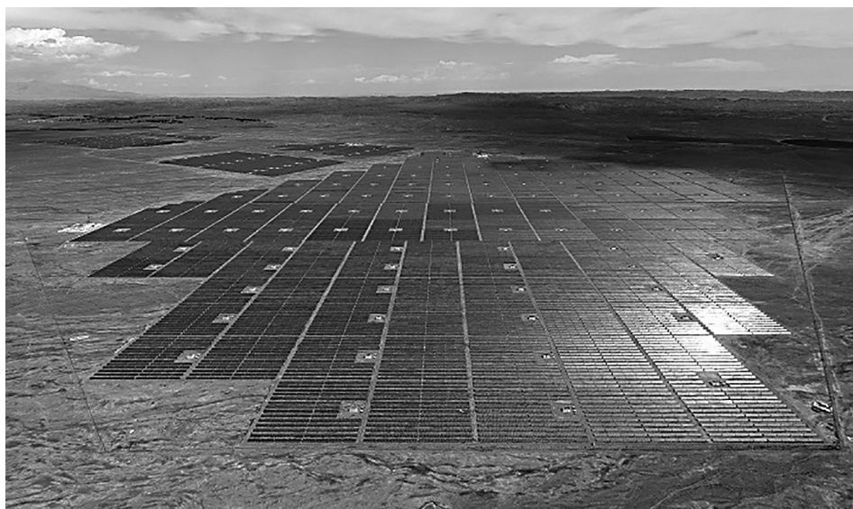
甘肃永昌200兆瓦地面电站一角
