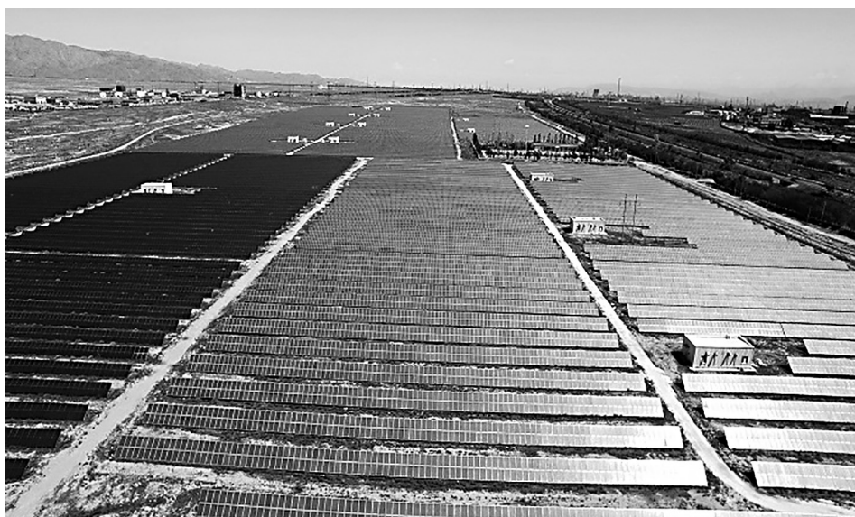
宁夏石嘴山20兆瓦地面电站，是正泰在国内投资兴建的首个太阳能电站
